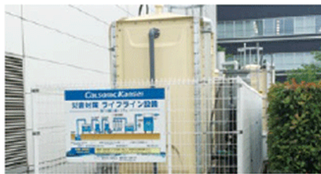
研究開発センター・本社に設置した 地下水膜ろ過システム
