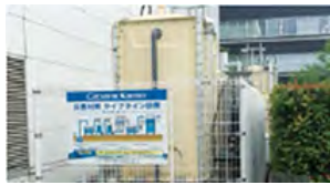
水膜ろ過システム
