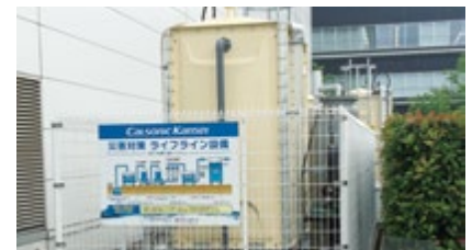
地下水膜ろ過システム
