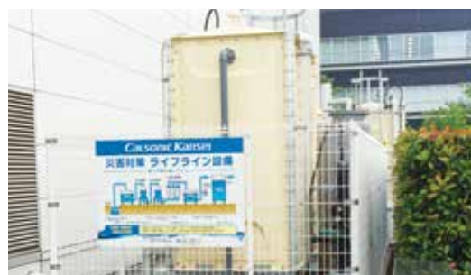
地下水膜ろ過システム
